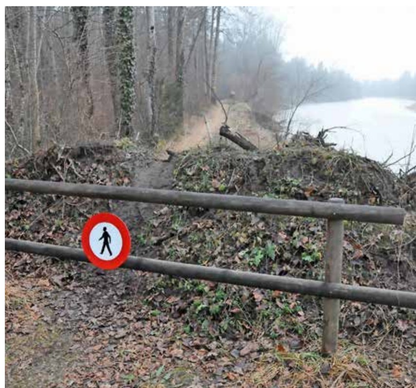
Dieser Abschnitt des erodierten Wanderwegs wurde bereits verlegt – zu gefährlich war die Seitwärtsbewegung der Thur geworden.
